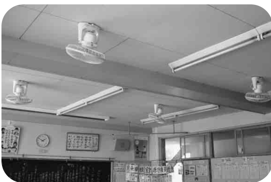
▶設置された天井扇風機
