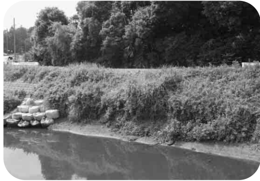
一部崩壊している西仁連川堤防
