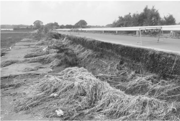
被害にあった道路(孫新橋付近)
