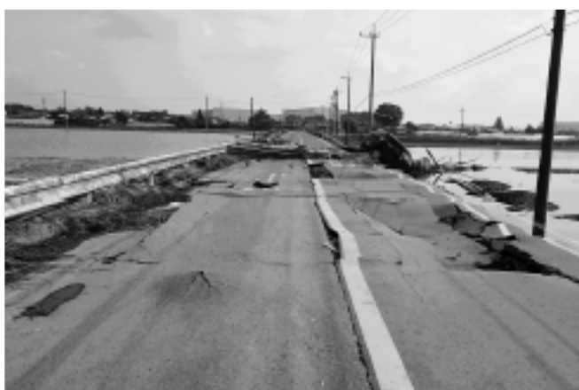
▲道路が破損し通行止めとなったライブライン
