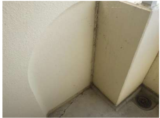
⑧ 壁目地の劣化（階段室）
