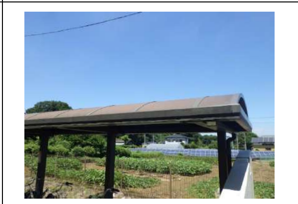
⑧ 屋根の劣化（駐輪場）
