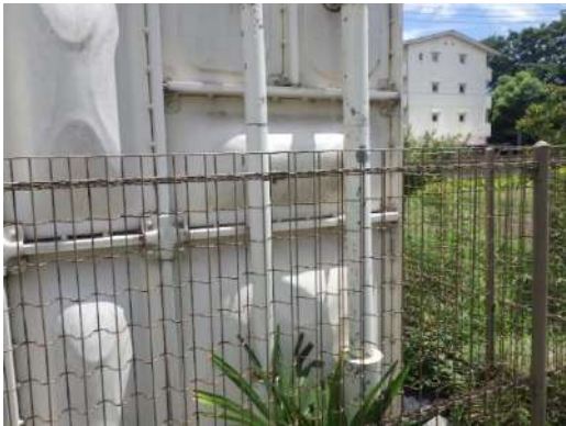
⑨ 塗装の劣化（受水槽）
