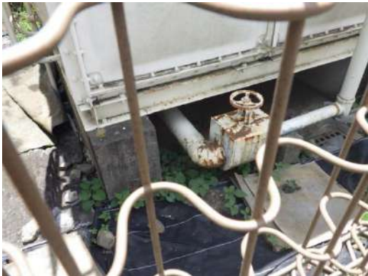
⑪ 鉄部の錆（受水槽）
