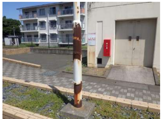
⑫ 鉄部の錆 (外灯)
