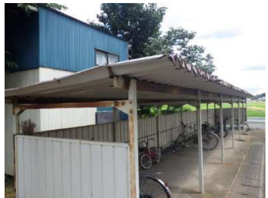
⑫ 鉄部の錆（駐輪場）
