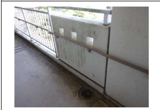
⑦ 手摺壁塗装の劣化・汚れ（外廊下）
