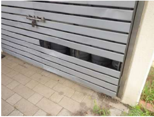
⑤ 扉の破損 (プロパン庫)
