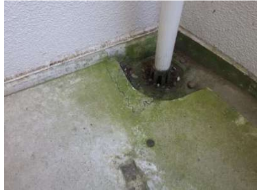
⑥ 床の破損（階段室）
