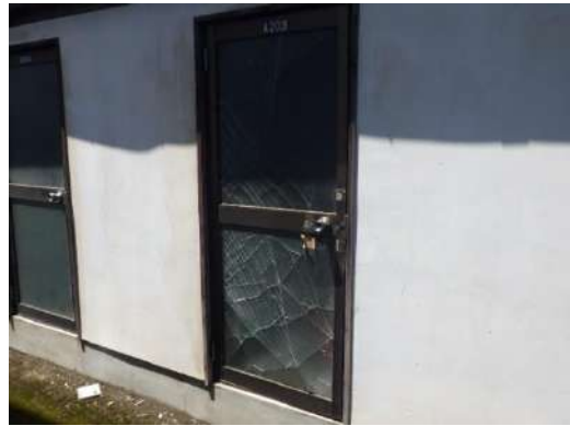
⑧ 建具（ガラス）の破損（物置）
