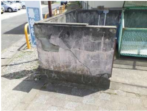
⑦ ゴミ集積所の破損
