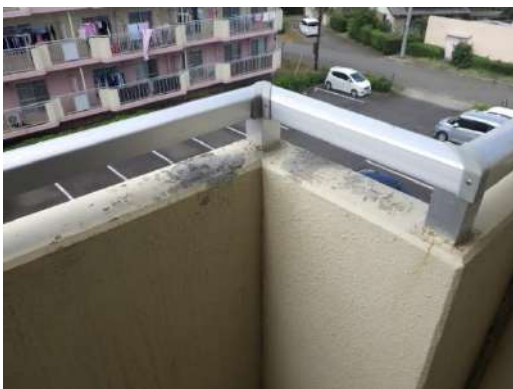
⑨ 手摺壁塗装の劣化（階段室）
