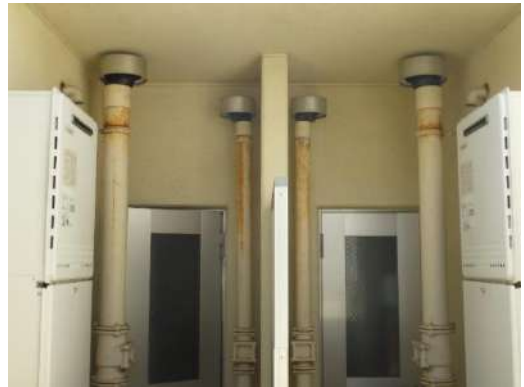
⑧ 鉄部の錆 (配管)
