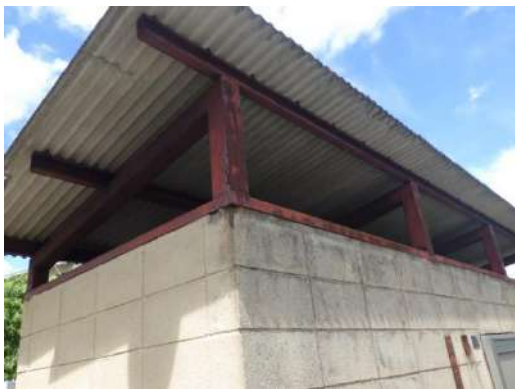
⑪ 鉄部の錆（プロパン庫）
