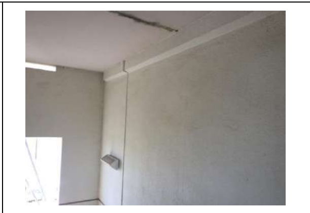
⑥ 壁塗装の劣化・汚れ（階段室）
