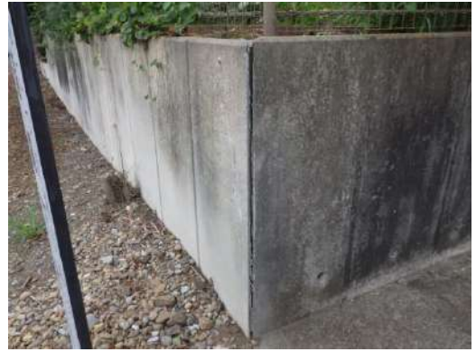
⑥ 土留めの隙間
