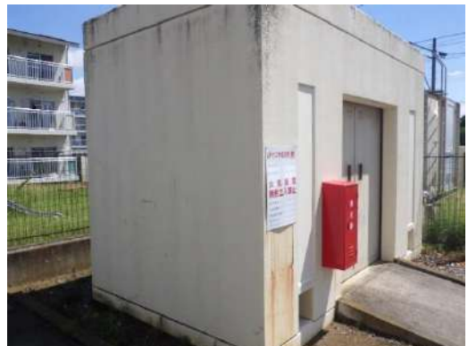
⑩ 塗装の劣化・汚れ (プロパン庫)
