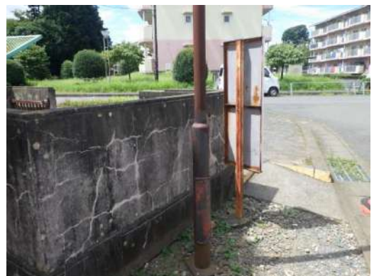
⑩ 鉄部の錆（外灯）
