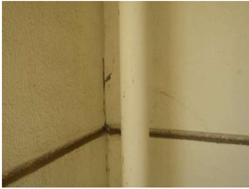
⑤ 壁のクラック (階段室)
