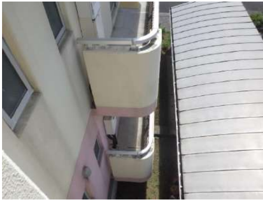
⑦ 手摺壁塗装の劣化（ベランダ）
