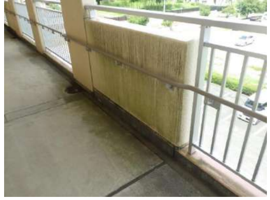
⑥ 手摺壁塗装の劣化・汚れ（外廊下）
