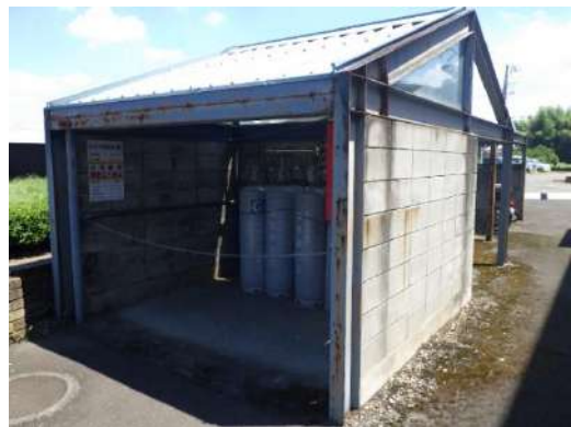
⑫ 鉄部の錆（プロパン庫）
