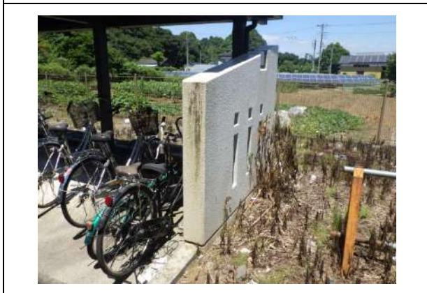
⑨ 塗装の劣化・汚れ（駐輪場）
