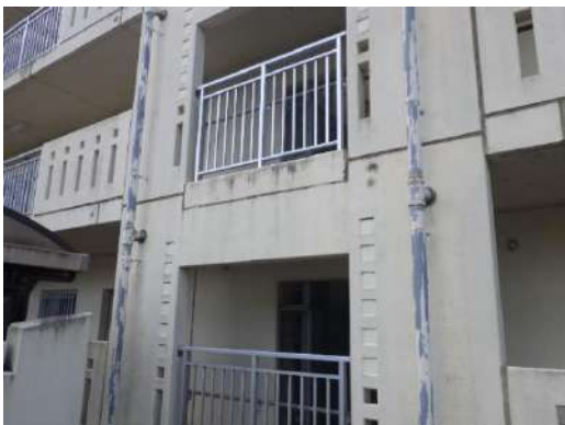
⑪ 塗装の劣化 (排水管)
