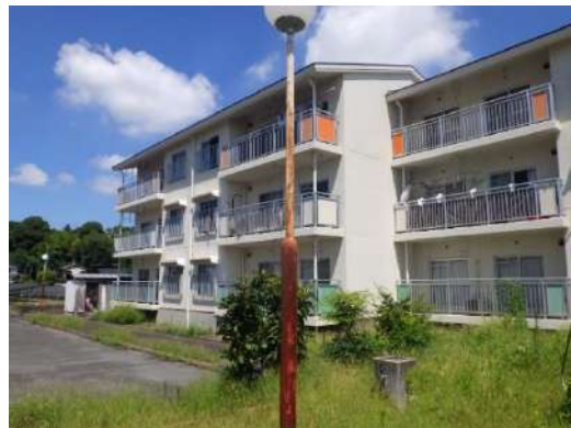
⑩ 鉄部の錆（外灯）
