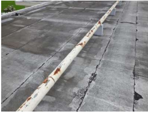
⑤ 配管の錆（屋根）
