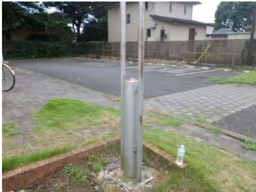
⑦ 鉄部の錆 (外灯)
