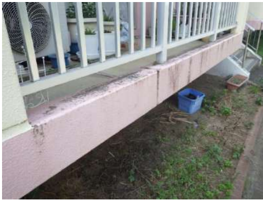
⑤ 外壁塗装の劣化・汚れ（南面）
