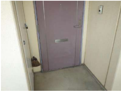
⑦ 塗装の劣化（玄関ドア）
