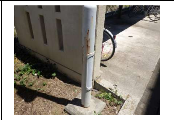
⑫ 鉄部の錆（外灯）
