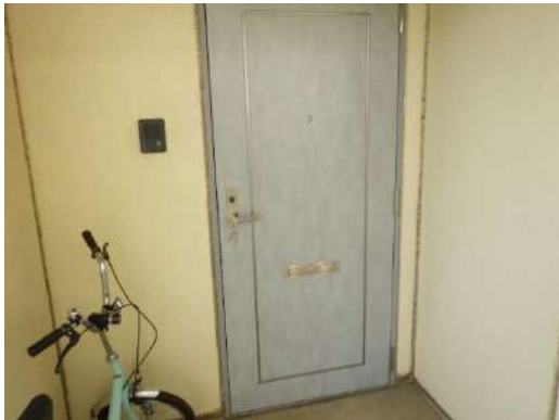
⑦ 塗装の劣化 (玄関ドア)
