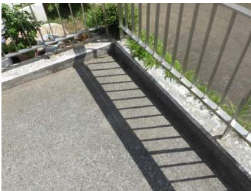
⑪ 塗装の劣化（スロープ）
