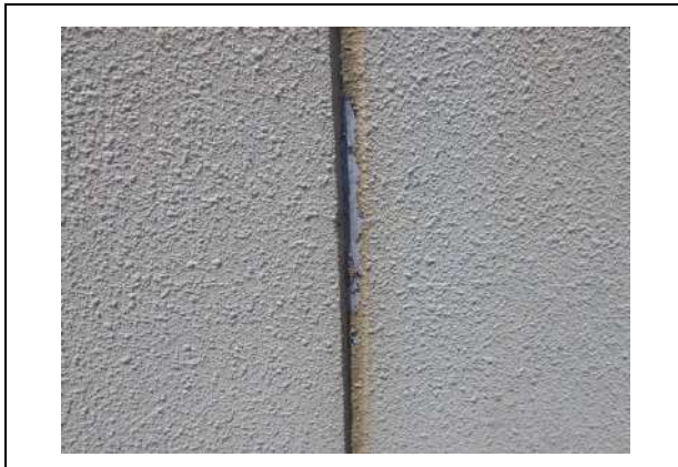
⑤ 目地の劣化（東面）
