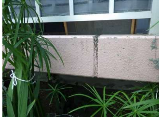
⑥ 目地の劣化（南面）
