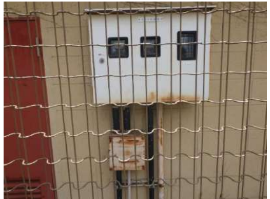
⑫ 鉄部の錆（受水槽室）
