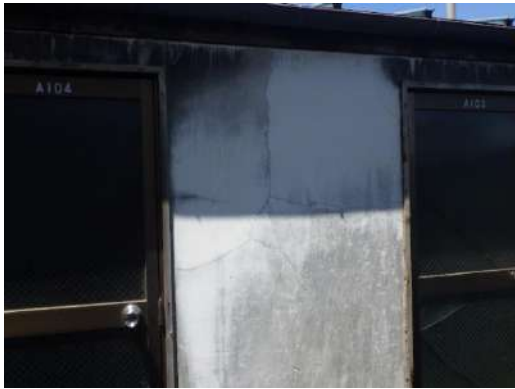
⑦ 壁のクラック（物置）
