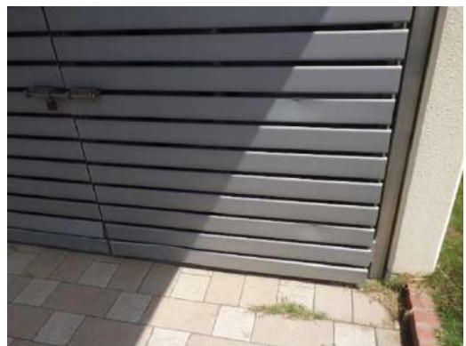
⑩ 扉の破損（プロパン庫）
