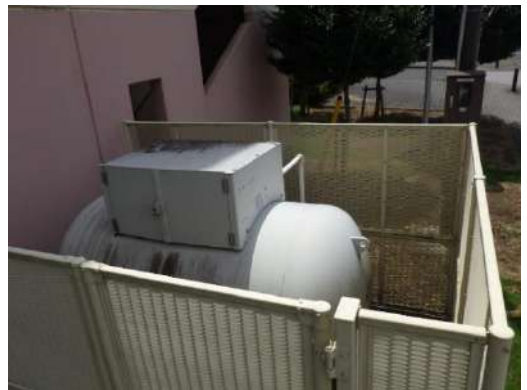
⑩ 塗装の劣化（ガスタンク）
