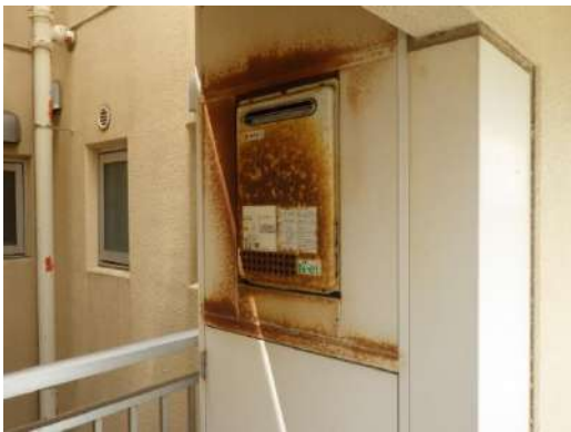
⑨ 鉄部の錆（パイプスペース）
