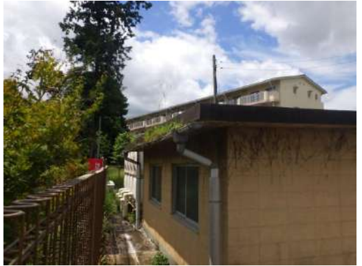
⑧ 雨樋の植生（受水槽室）
