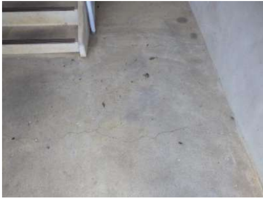
⑤ 床のクラック（階段室）
