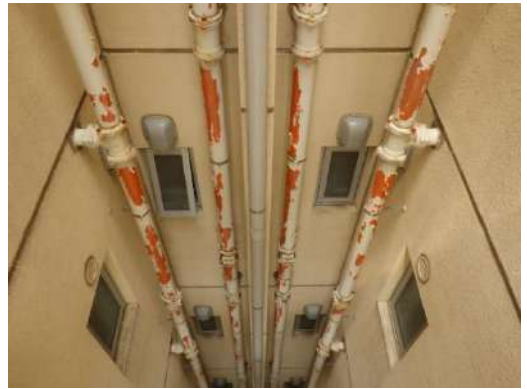
⑧ 塗装の劣化（配管）
