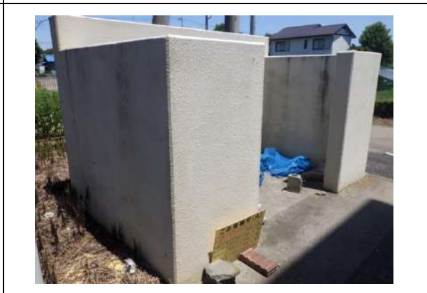
⑩ 塗装の劣化・汚れ（ゴミ集積所）
