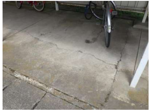
⑧ 駐輪場床のクラック
