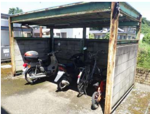
⑪ 鉄部の錆（駐輪場）
