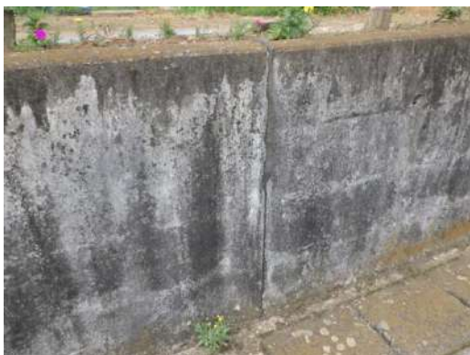
⑨ 土留め目地の劣化
