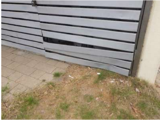
⑦ 扉の破損（プロパン庫）
