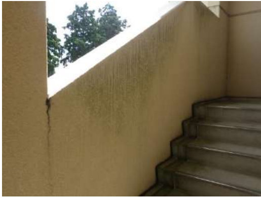
⑤ 壁塗装の劣化・汚れ（階段室）
