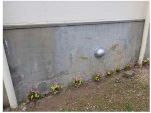
⑥ 腰壁のクラック・浮き（北面）
