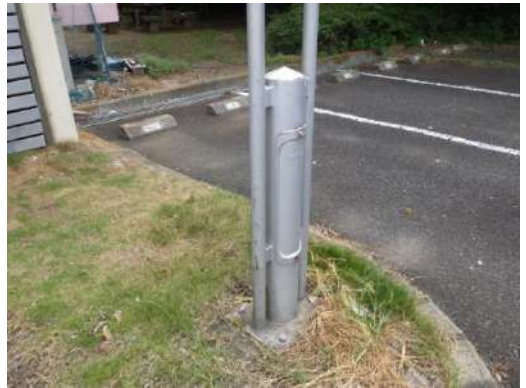
⑩ 塗装の劣化（外灯）
