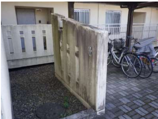
⑨ 塗装の劣化・汚れ (駐輪場)
