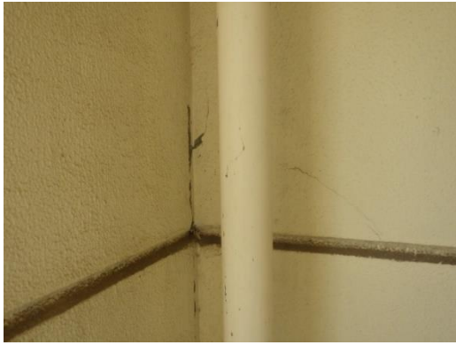
⑤ 壁のクラック (階段室)
