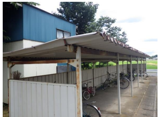
⑫ 鉄部の錆（駐輪場）
