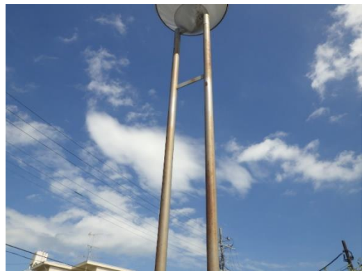
⑫ 塗装の劣化 (外灯)
