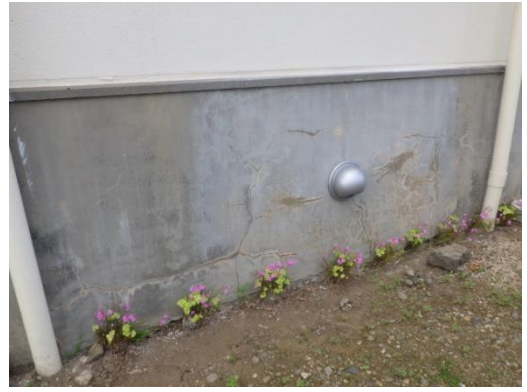
⑥ 腰壁のクラック・浮き（北面）
