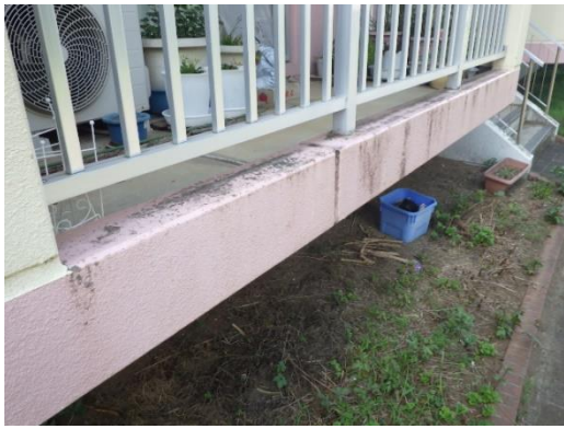
⑤ 外壁塗装の劣化・汚れ (南面)
