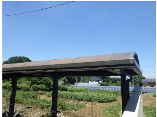
⑧ 屋根の劣化（駐輪場）
