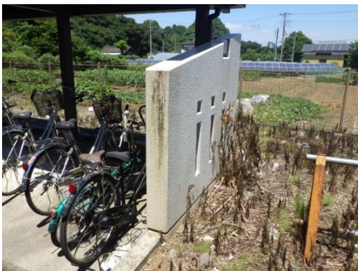
⑨ 塗装の劣化・汚れ（駐輪場）
