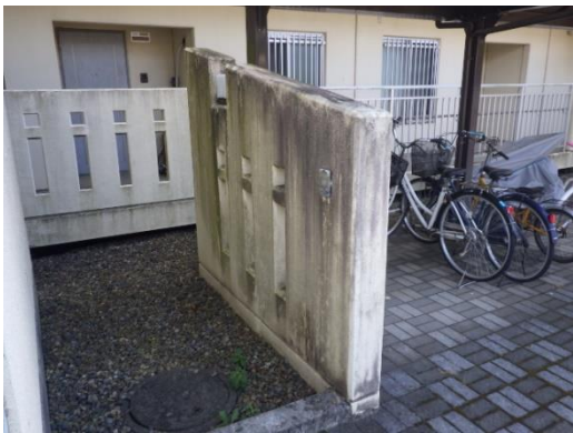
⑨ 塗装の劣化・汚れ (駐輪場)
