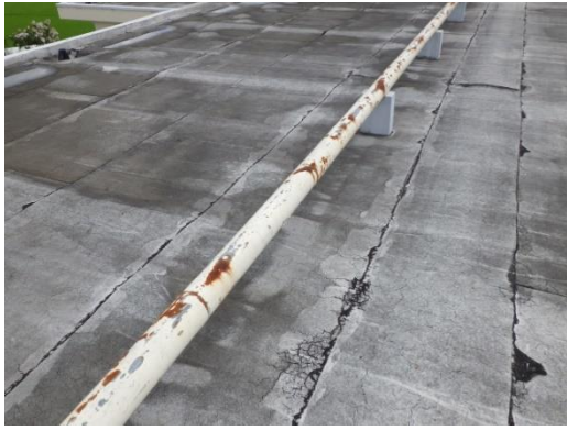
⑤ 配管の錆（屋根）
