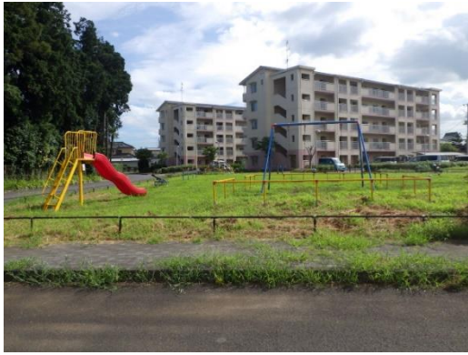
⑤ 遊具の劣化
