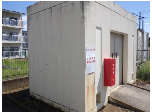
⑩ 塗装の劣化・汚れ (プロパン庫)
