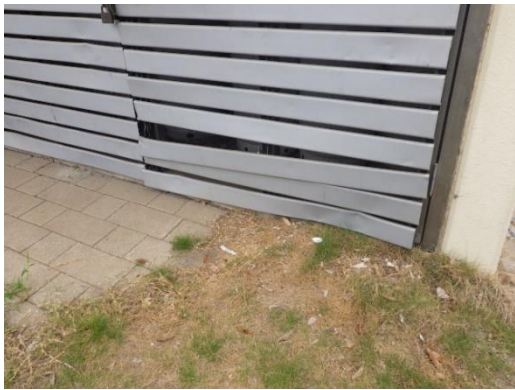
⑦ 扉の破損 (プロパン庫)
