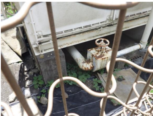
⑪ 鉄部の錆 (受水槽)
