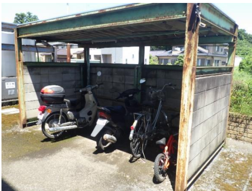
⑪ 鉄部の錆 (駐輪場)
