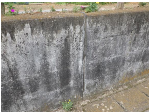
⑨ 土留め目地の劣化
