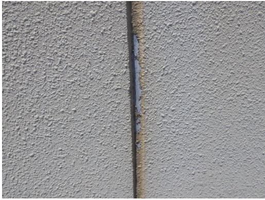
⑤ 目地の劣化（東面）
