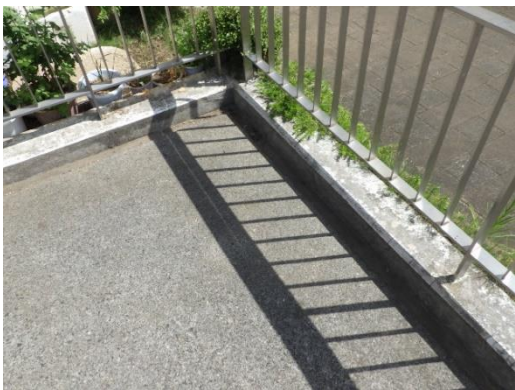
⑪ 塗装の劣化 (スロープ)
