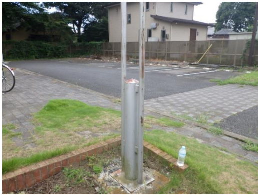
⑦ 鉄部の錆 (外灯)
