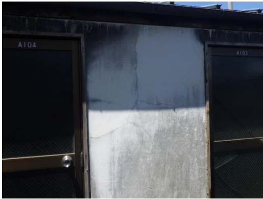
⑦ 壁のクラック (物置)
