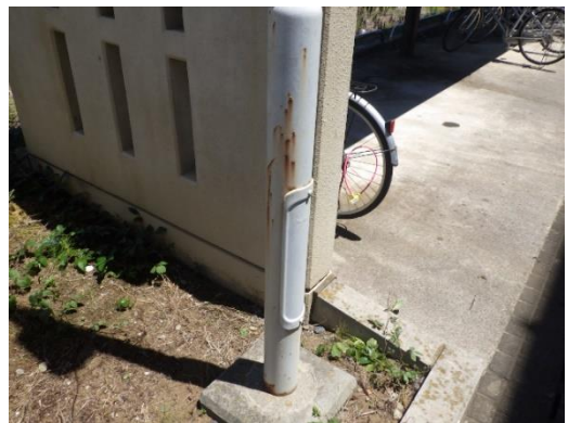
⑫ 鉄部の錆（外灯）
