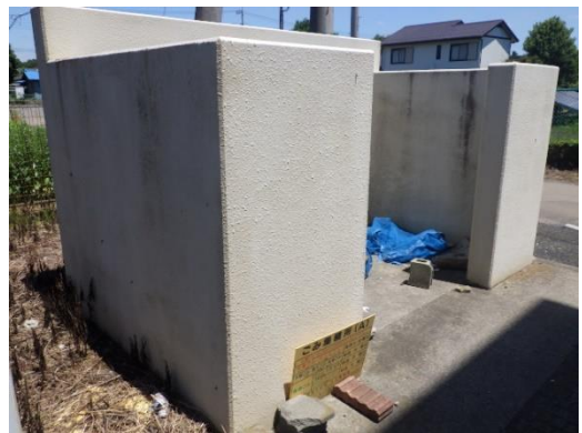
⑩ 塗装の劣化・汚れ（ゴミ集積所）
