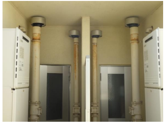
⑧ 鉄部の錆 (配管)
