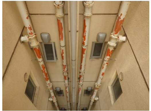
⑧ 塗装の劣化（配管）
