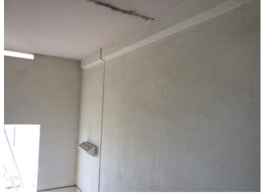
⑥ 壁塗装の劣化・汚れ（階段室）
