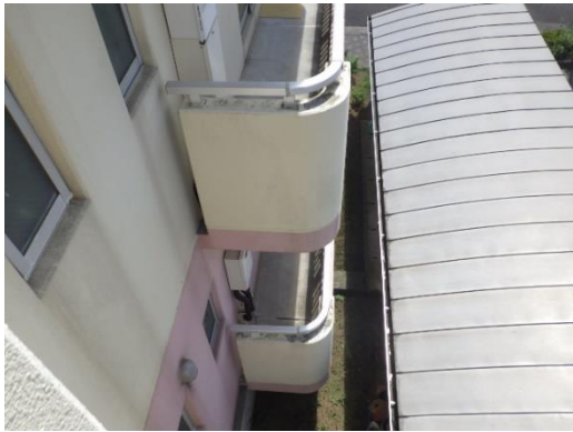
⑦ 手摺壁塗装の劣化 (ベランダ)
