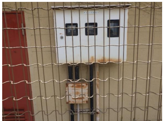
⑫ 鉄部の錆 (受水槽室)
