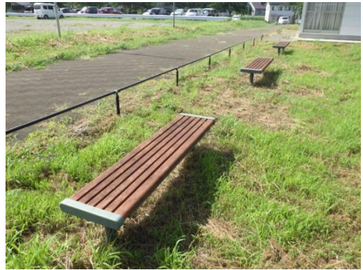
⑧ ベンチの劣化
