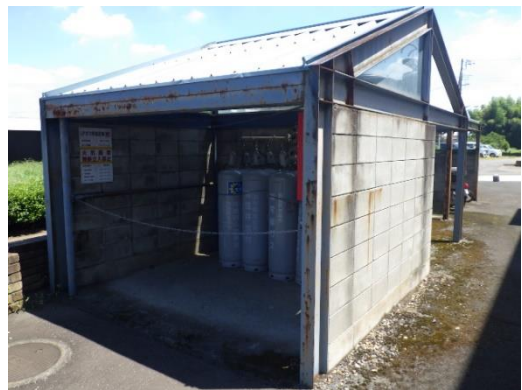
⑫ 鉄部の錆 (プロパン庫)
