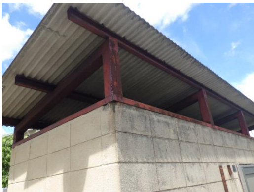
⑪ 鉄部の錆（プロパン庫）
