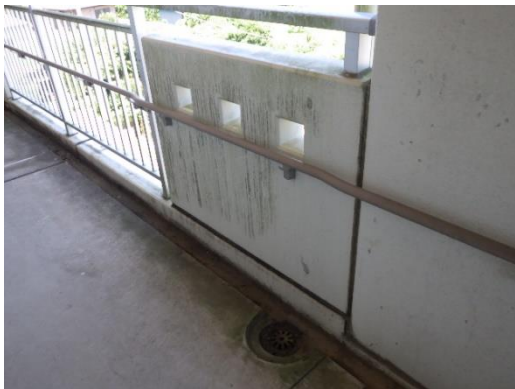
⑦ 手摺壁塗装の劣化・汚れ（外廊下）
