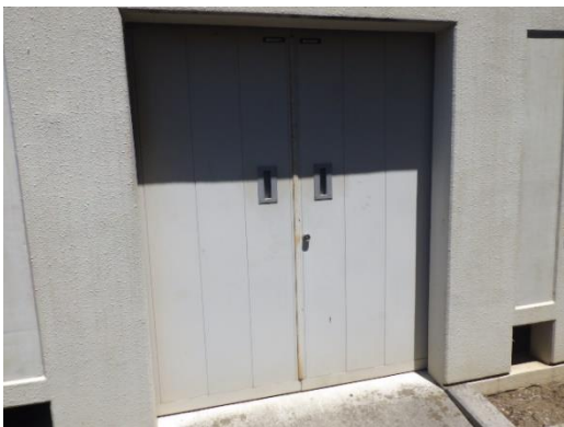
⑪ 鉄部の錆（プロパン庫）
