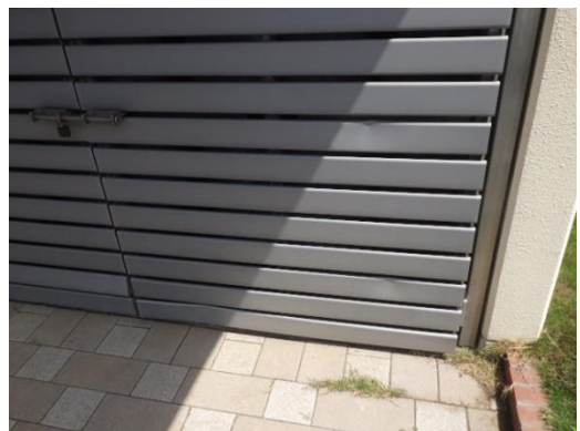
⑩ 扉の破損 (プロパン庫)
