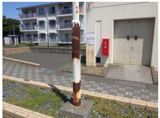
⑫ 鉄部の錆 (外灯)
