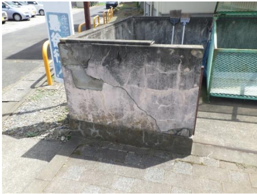
⑦ ゴミ集積所の破損
