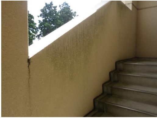
⑤ 壁塗装の劣化・汚れ（階段室）
