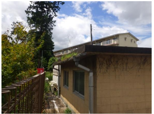
⑧ 雨樋の植生 (受水槽室)
