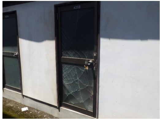
⑧ 建具 (ガラス) の破損 (物置)
