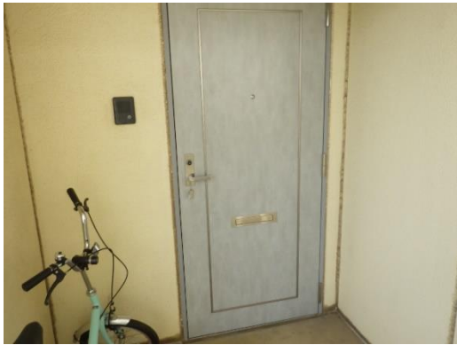
⑦ 塗装の劣化 (玄関ドア)
