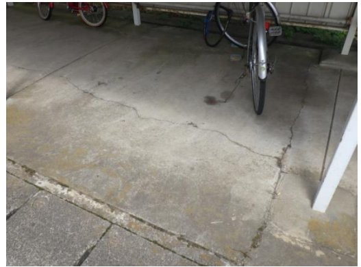
⑧ 駐輪場床のクラック
