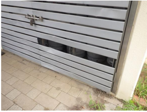
⑤ 扉の破損 (プロパン庫)
