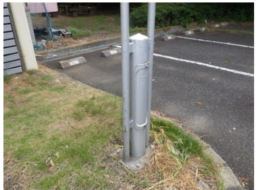
⑩ 塗装の劣化 (外灯)
