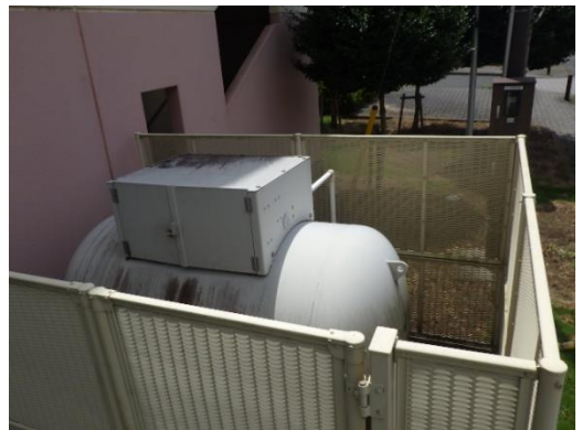
⑩ 塗装の劣化（ガスタンク）
