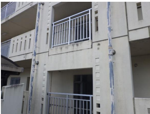
⑪ 塗装の劣化 (排水管)
