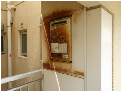
⑨ 鉄部の錆（パイプスペース）
