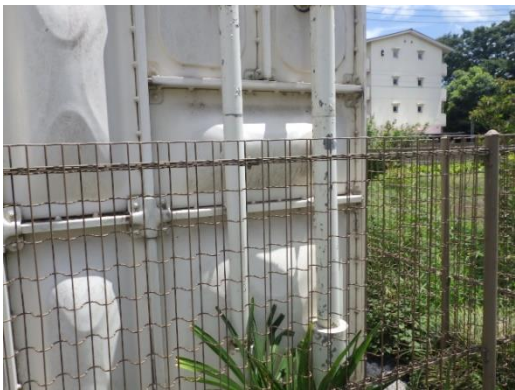
⑨ 塗装の劣化 (受水槽)
