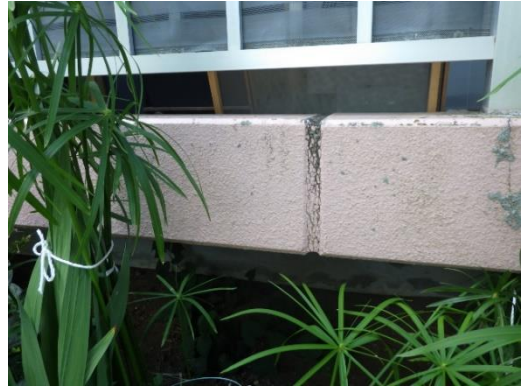
⑥ 目地の劣化 (南面)
