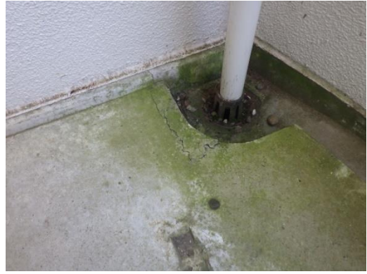
⑥ 床の破損 (階段室)
