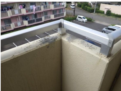
⑨ 手摺壁塗装の劣化 (階段室)
