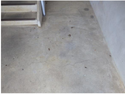
⑤ 床のクラック (階段室)
