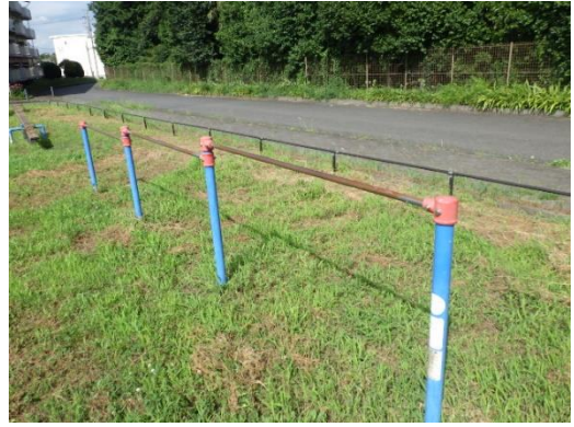
⑥ 遊具の劣化
