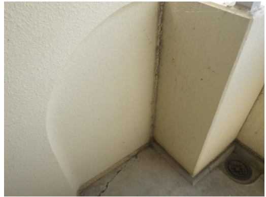
⑧ 壁目地の劣化 (階段室)
