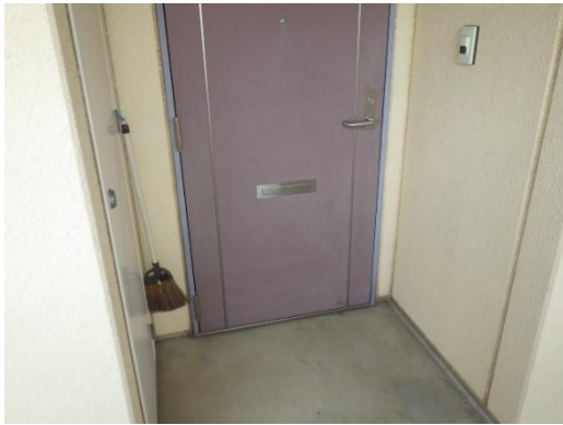
⑦ 塗装の劣化（玄関ドア）
