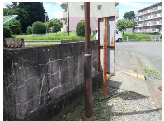
⑩ 鉄部の錆（外灯）
