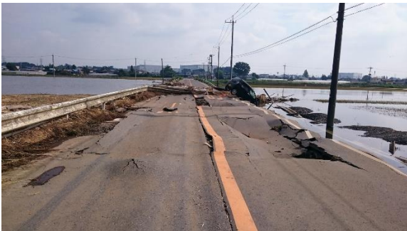
豪雨による道路の崩壊
