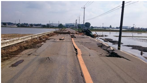
豪雨による道路の崩壊
