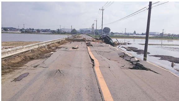
豪雨による道路の崩壊
