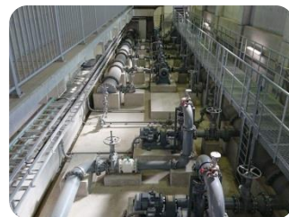
岩井浄水場【ポンプ室】
