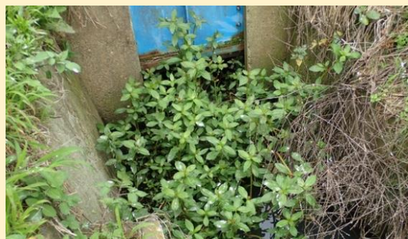
水路での繁茂
