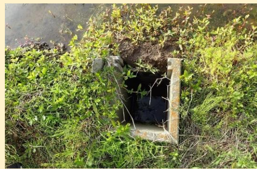
水田給水栓付近での繁茂
